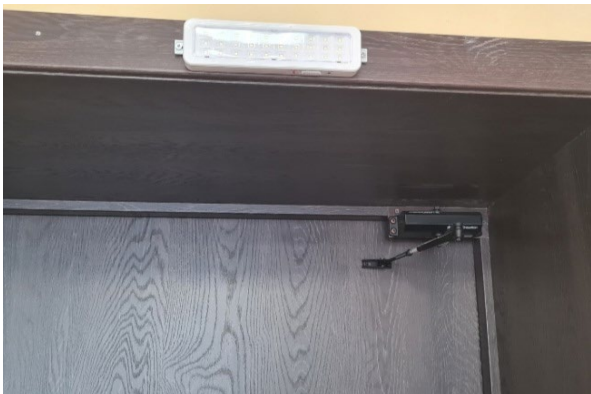
Фото аварийного освещения и дверного доводчика с задержкой закрывания.
